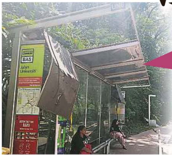
↑ 尚未脱落的遮棚也出现损坏迹象。
